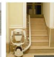
Silla salvaescaleras de acceso a la sala de exposiciones temporales B.
