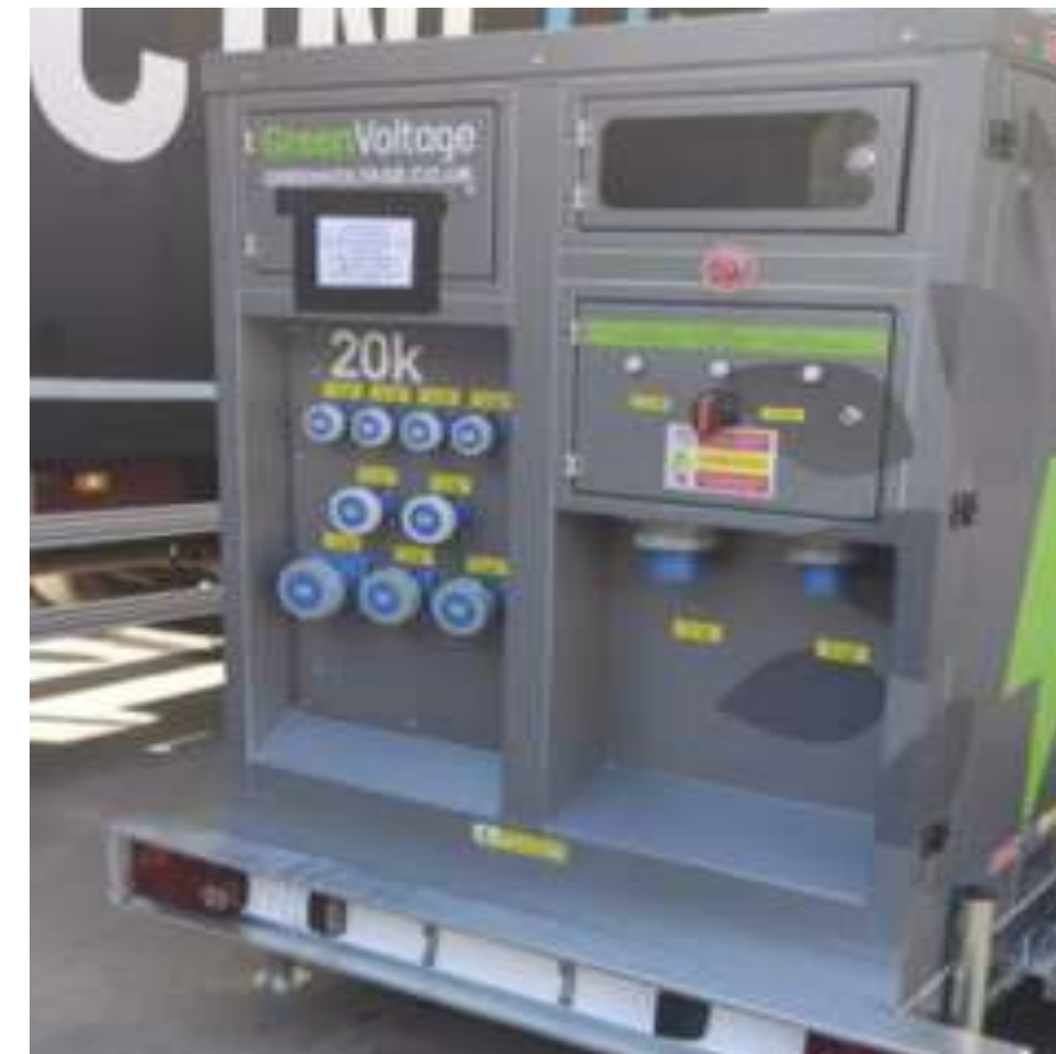
GENERADOR ELÈCTRIC ZERO EMISSIONS 20 kVAh Kinogreen
